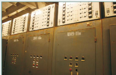
Передачи постоянного тока, ШР, УПК, СТК, СТАТКОМ
