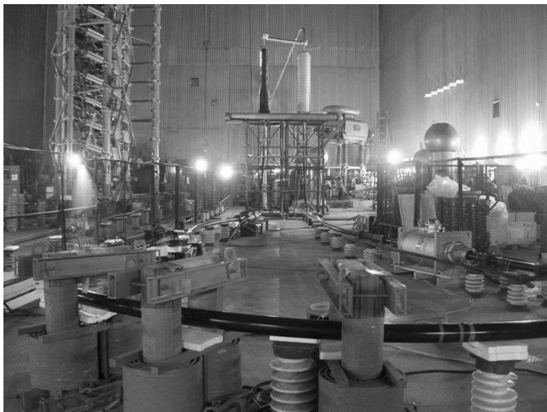
Рис. 5. Фотография испытываемой кабельной системы 220 кВ
