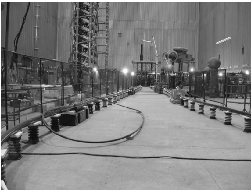
Рис. 7. Фотография испытуемой кабельной системы 220 кВ
