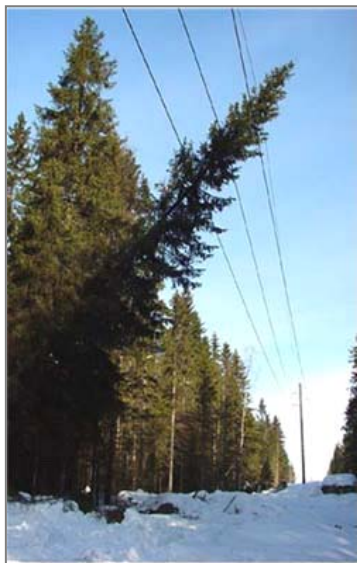
Рис. 5. Падение дерева на ВЛ 110 кВ с изолированными проводами без обрыва проводов и отключения ВЛ (Финляндия)
