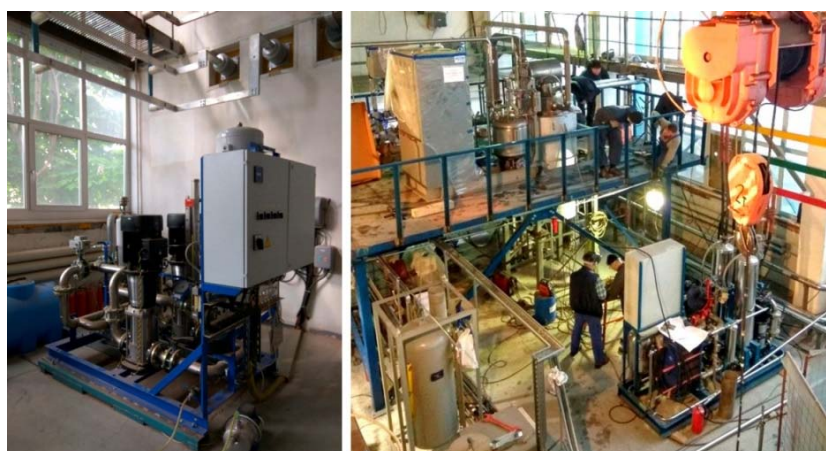
Рис. 9. Система охлаждения тиристорных вентилях испытательного стенда (слева) и штатная СКО ВТСП КЛ в процессе монтажа и наладки (справа)
