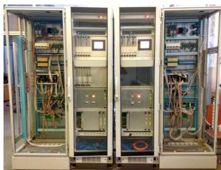
Рис. 8. ШУ (в центре) и шкафы СУРЗА (по краям) выпрямительной и инверторной частей КВПУ в составе 3-пульсной кольцевой испытательной схемы
