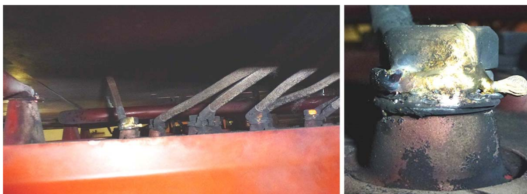
Рис. 3. Результаты горения дуги на главных выводах и выводах отпайки РПН трансформатора собственных нужд
