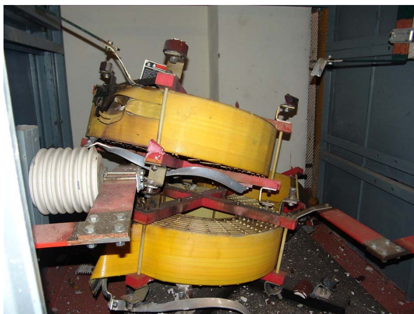
Рис. 2. Разрушение фаз токоограничивающих реакторов в цепи трансформатора собственных нужд
